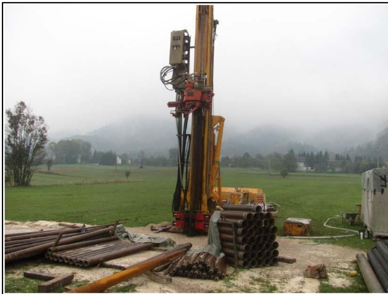
Slika 2.6 Primjer mehanizacije za vodoistražno bušenje (Izvor: Izvješčaj o vodoistražnim radovima na području Korenice, 2013.)
